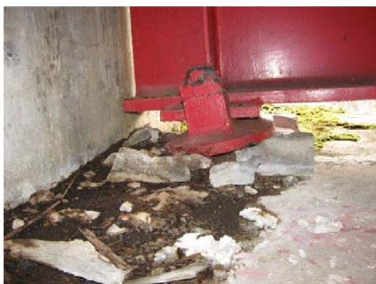
写真4-20 【損傷】支承の機能障害
