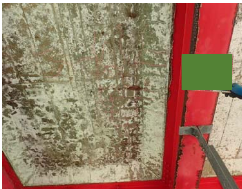
写真4-22 RC床版のひびわれ 錆汁を伴う漏水・遊離石灰
