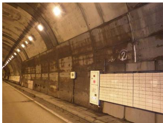
写真4-11 【損傷】補修前（旧面導水撤去時）
