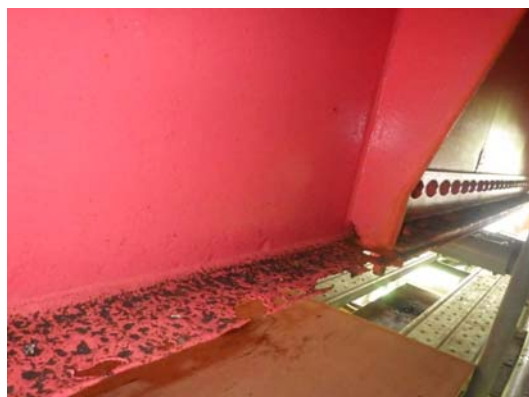
写真4-5 【損傷】横桁の腐食
