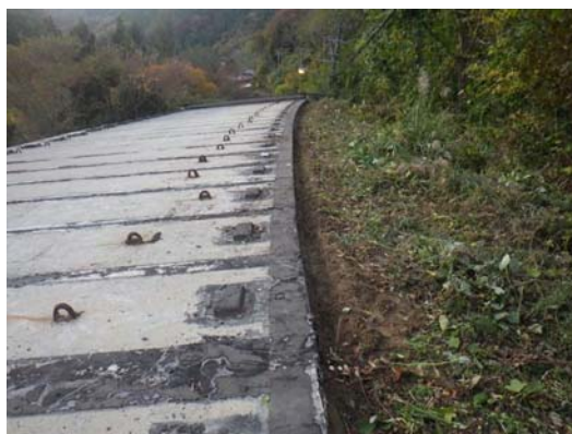
写真4-17 【損傷】防水の劣化
