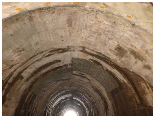
写真4-14 【損傷】 うき、はく落、欠損、漏水
