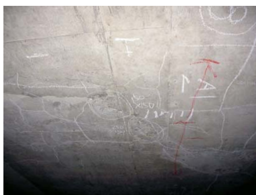
写真4-2 【損傷】床版補修前
