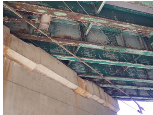
写真4-23 主桁の全般的な腐食
