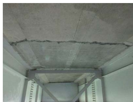
写真4-3 【対策】部分打替え・主桁塗装
