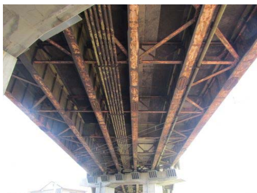
写真4-8 【損傷】鋼材の腐食
