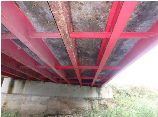
写真4-8 【損傷】 主桁の腐食、防食機能の劣化 床版ひびわれ
