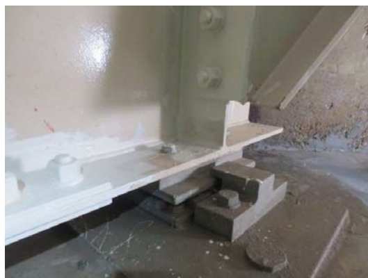
写真4-15 【対策】 主桁部分交換、支承交換
