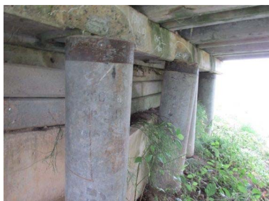
写真4-14 【損傷】 パイルベント基礎の傾斜
