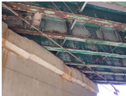
写真3-4 主桁の全般的な腐食
