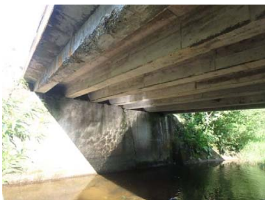
写真4-5 【損傷】主桁の断面欠損
