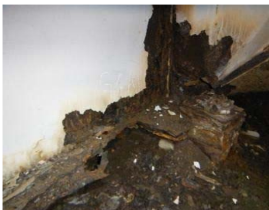
写真4-14 【損傷】 主桁の腐食、欠損、支承の腐食
