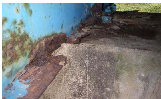
写真4-17 【損傷】 主桁下フランジの欠損
