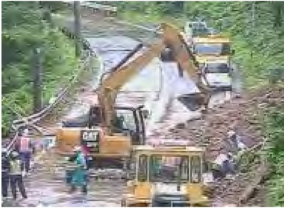
▲国道 47 号への土砂流入 (最上町 H30.8)
