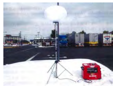
道の駅「天童温泉」における屋外照明施設
