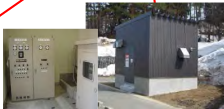
無停電化(非常用発電装置) ・概ね3日間連続運転可能 ・情報提供施設、トイレへ電気を供給
