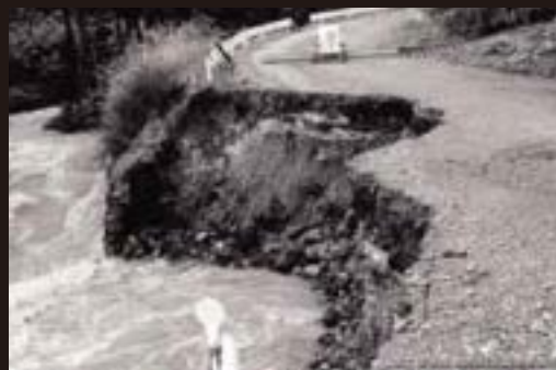
吉野地区道路損壊(南陽市)
