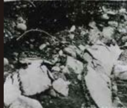
R113号赤芝発電所付近の被害(小国町)
