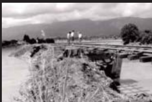
崩壊した長井線(白鷹町)
