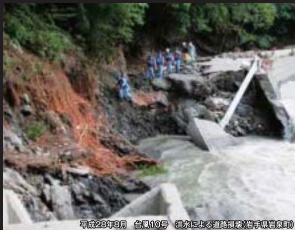
平成28年8月 台風10号 洪水による道路損壊(岩手県岩泉町)
