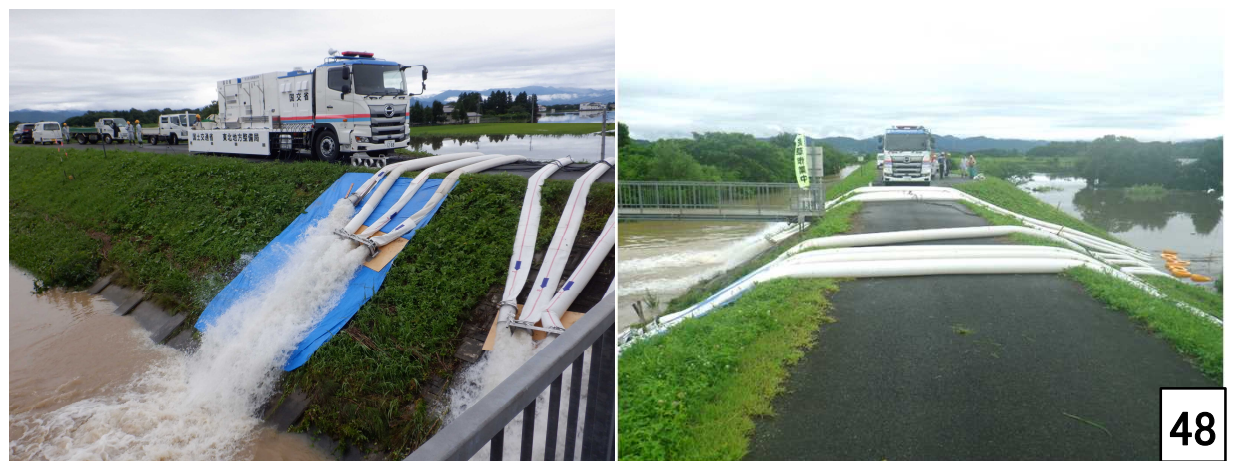
令和4年8月出水 南陽市鬼神川水門 排水ポンプ車 60m 3 /min×1台
