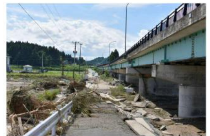
新庄市畑地区の浸水被害
