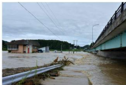
新庄市畑地区の浸水被害
