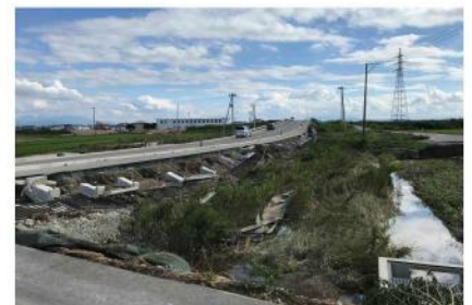
浸水による道路の被災
