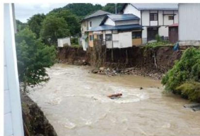
山形市長谷堂 木沢川 護岸破損
