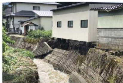
上市市下生居 生居川 護岸破損
