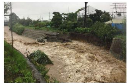
山形市門伝 富神川 護岸破損
