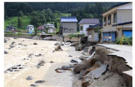
銅山川脇の村道被害
