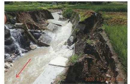
舟形町堀内 松橋川 護岸破損
