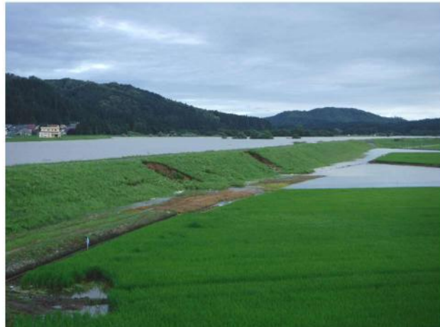
大石田町岩ヶ袋地区、漏水による堤防欠損
