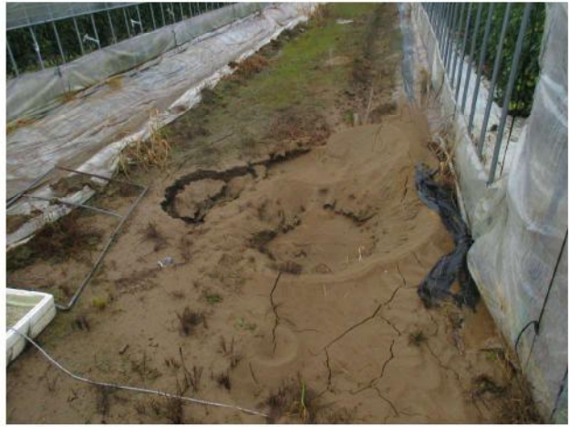
大蔵村清水地区、漏水による噴砂痕
