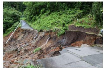
西里(浦田)地区 山間部道路崩落
