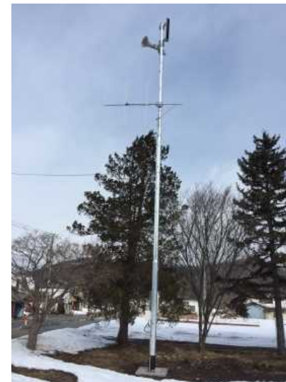
【防災行政無線の整備】 屋外拡声子局76箇所設置 戸別受信機を避難所、福祉施設、音声 難聴世帯へ設置
