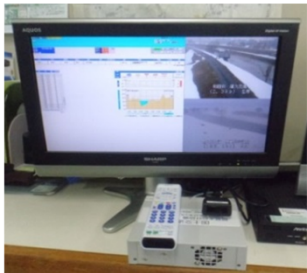
簡易水位計 表示装置(南陽市)
