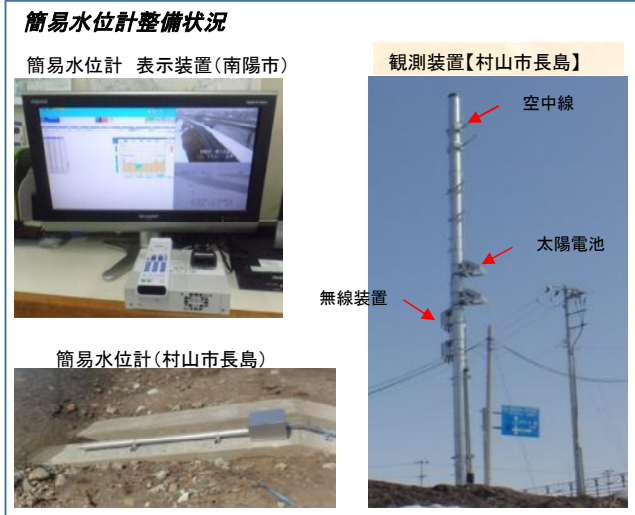
水リスクが高い箇所リアルタイムに水位を把握するための簡易水位計の設置
