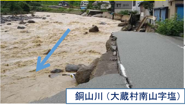
濁流により護岸(約80m)が流出
