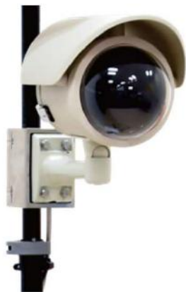
設置した簡易型河川監視カメラ
