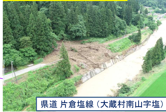
路肩が約20mに渡り崩落
