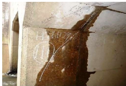
樋管・樋門の漏水状況
