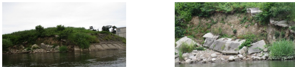
河岸崩壊の状況
