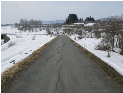
堤防の天端舗装補修前の状況
