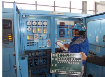
ゲート設備点検
