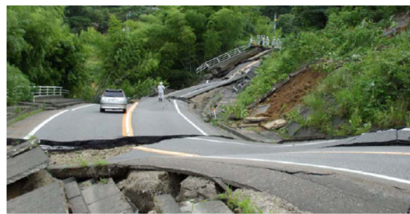
被災状況調査
