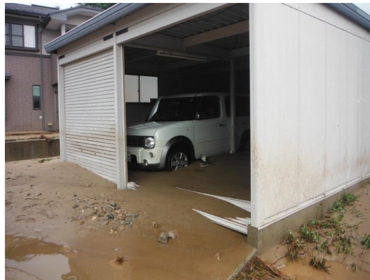
浸水による土砂堆積
