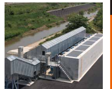
大旦川排水機場 (村山市)
