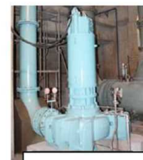
設備機械の防水化（耐水型モーター）
