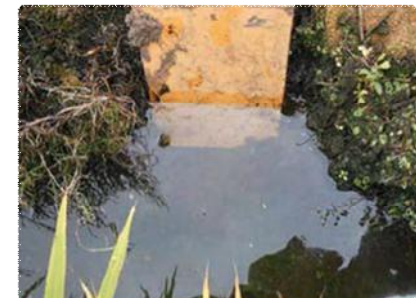
止水板による止水状況 (出典：国土強靱化民間の取組事例集)
