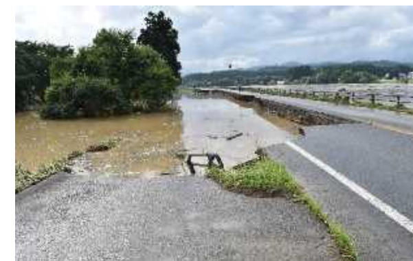
《最上川45.3k付近の浸水被害状況》
