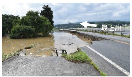
【国】最上川44.3km付近(堤防欠損状況)
