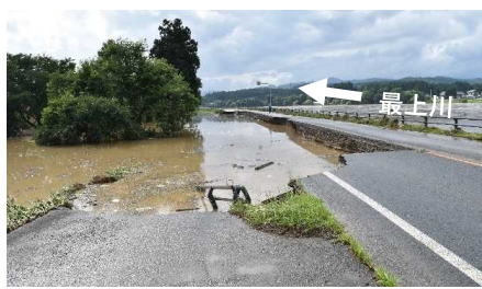
【国】最上川44.3k付近(堤防欠損状況)
