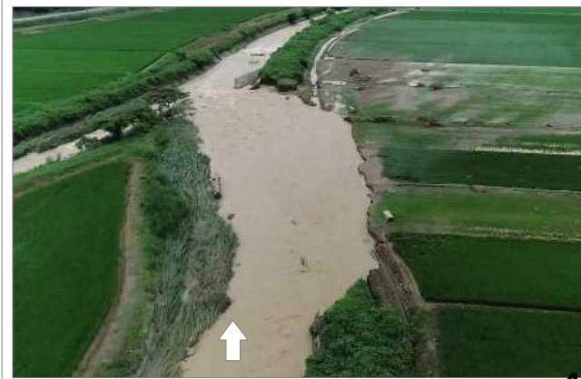
堤防決壊 - 野尻川（尾花沢市寺内）
