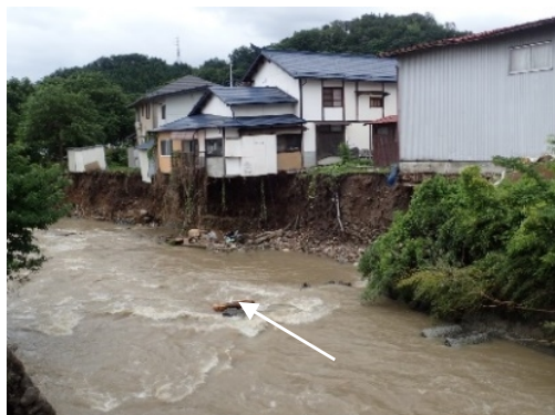
被災状況(R2.7.29)
