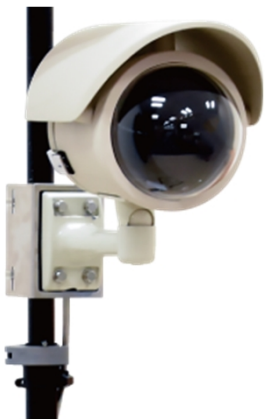
設置した簡易型河川監視カメラ
