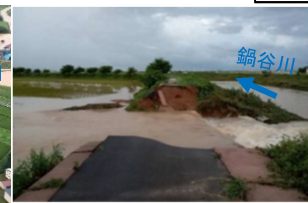
梯川水系鍋谷川の堤防決壊による氾濫状況(石川県 小松市)
