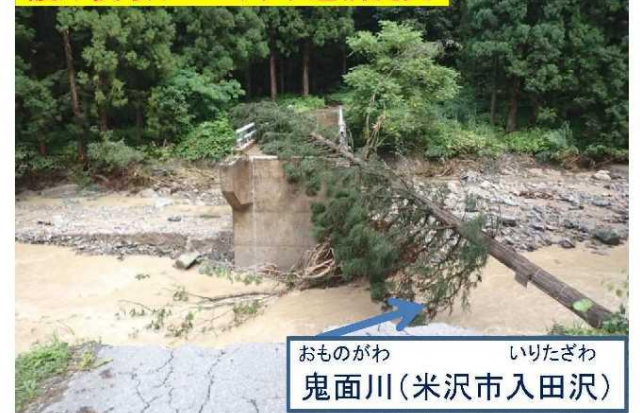
護岸損壊(120m)、市道橋流失
