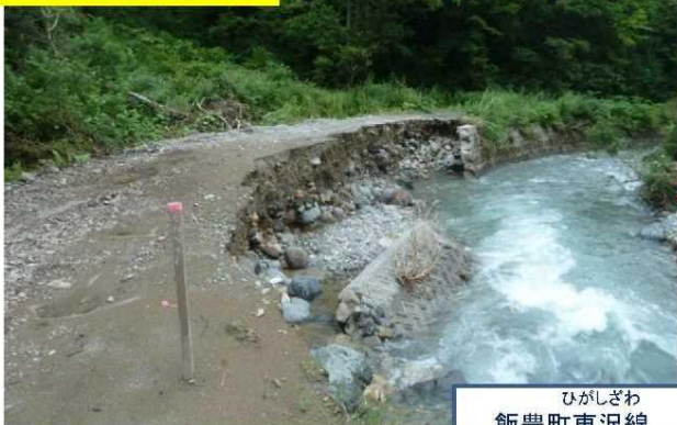
林道擁壁の損壊
