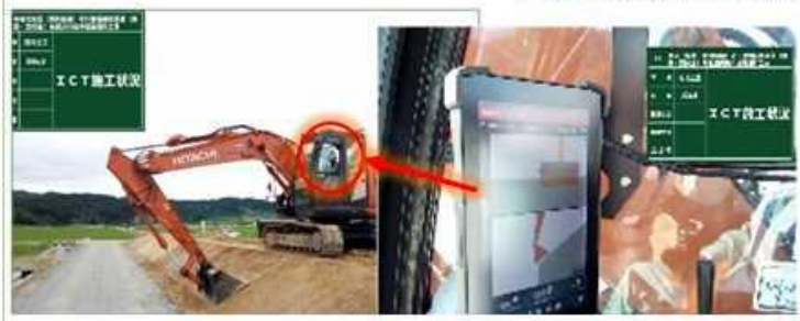
築堤工事で「ICT施工」を実施、工期短縮等により生産性向上
