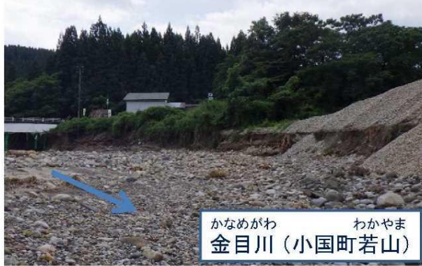
河岸崩壊(50m)及び除雪基地の浸水
