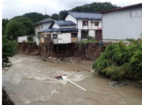
被災状況(R2.7.29)
