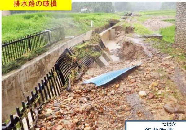
排水路の破損
