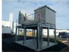
約2.5mの高台の上に設置した非常用電源装置
