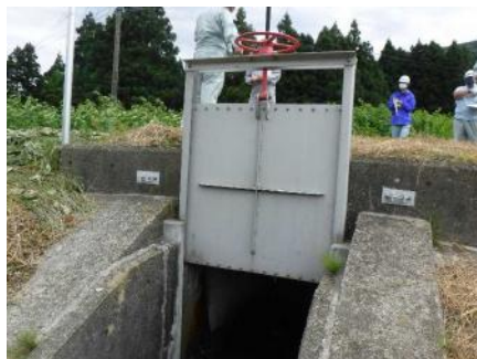
▲根掘沢排水樋管（大町溝土地改良区と合同）
