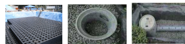
<雨水貯留浸透施設(左から貯留施設、浸透ます、浸透トレンチ)>
