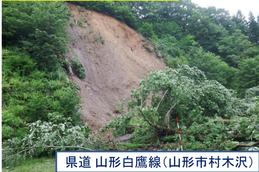
道路法面が約40mに渡り崩落
