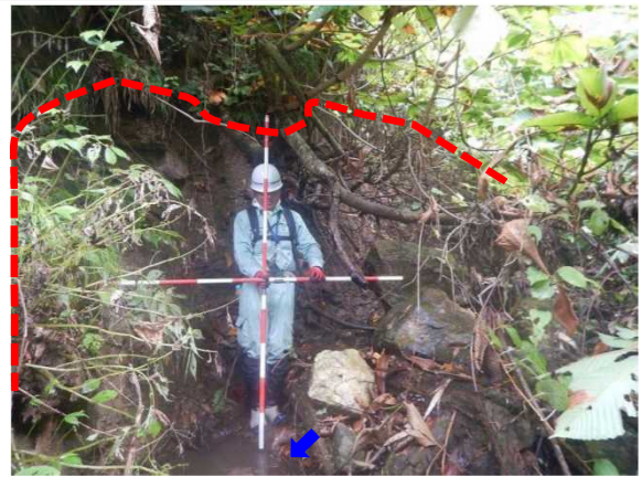
流域の荒廃状況
