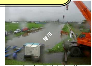
平成25年7月洪水時の状況
