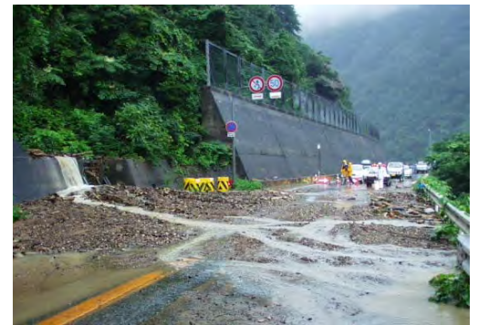
▲国道47号猪ノ鼻地区の被災状況
