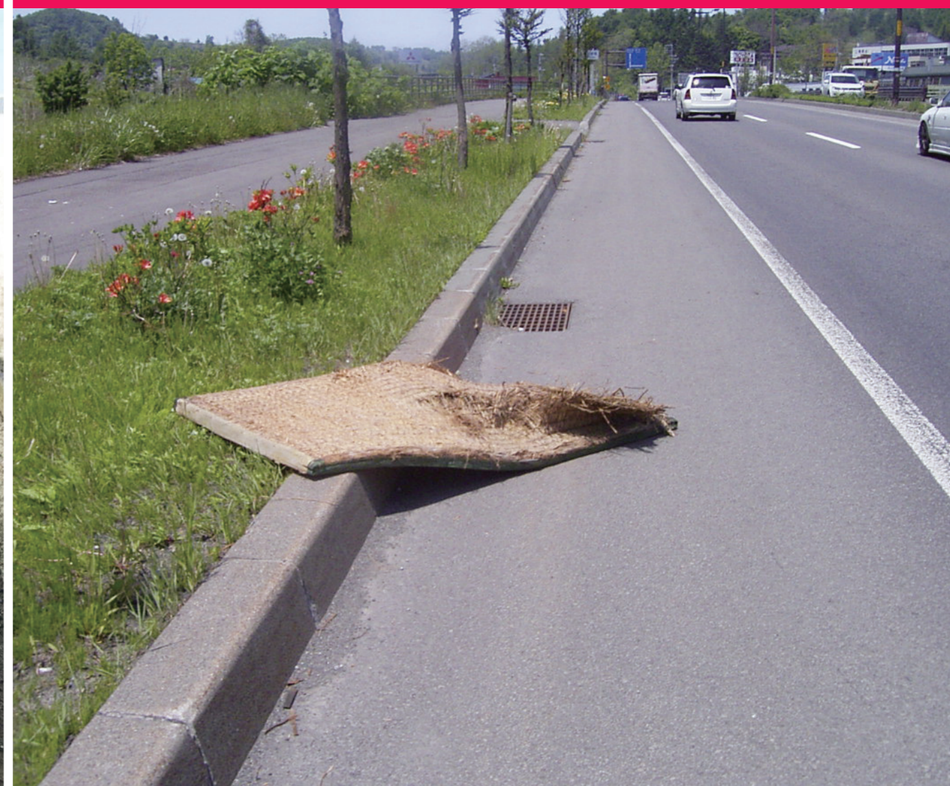
路面の落下物
