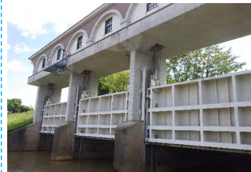
↑ 福部内川水門の遠隔操作訓練状況
