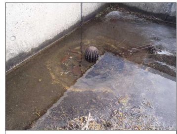
屋上ルーフトレイン(排水口) 【このように水が溜まる前に堆積物の除去を】
