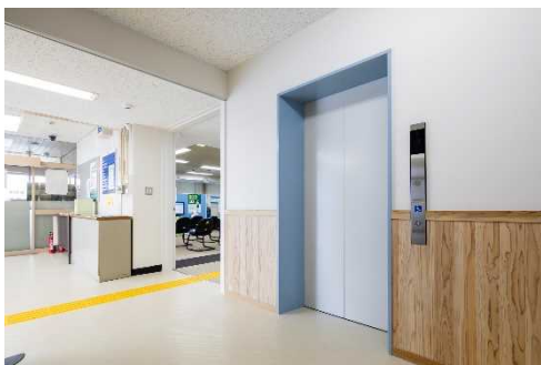
(写真) 既存庁舎 車いす対応エレベーター 既存庁舎内部に新しくエレベーターシャフトを構築し13人乗を1台整備しています。
