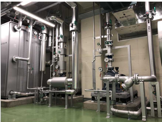
【改修を行った機械室内部の状況】
