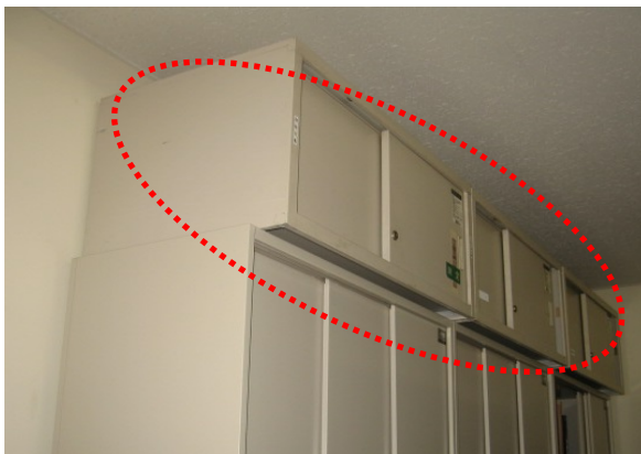
上部置棚が固定されていない
