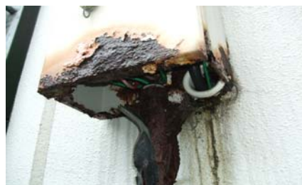
腐食(錆)により底が損傷
