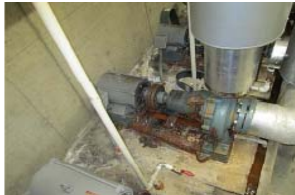
ポンプ腐食状況
