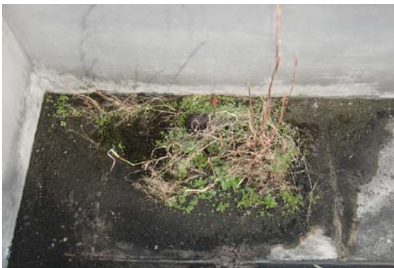
泥が詰まった排水口
