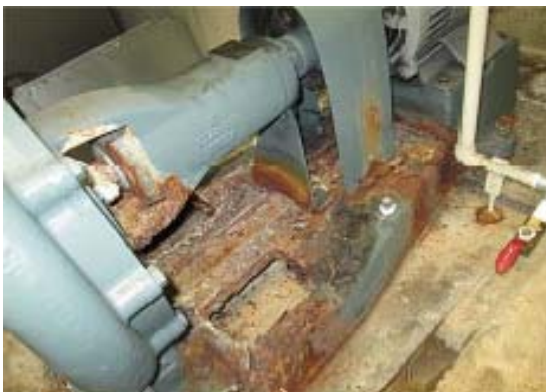
ポンプ腐食状況
