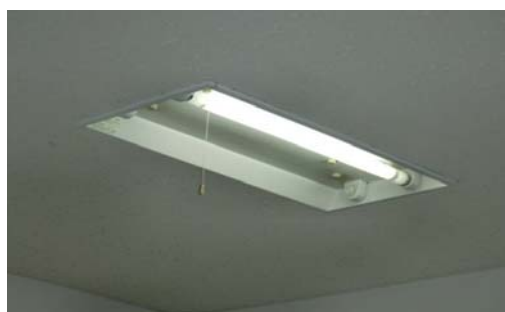
蛍光管が間引かれた非常用照明器具
