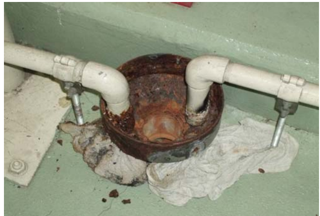
間接排水口 腐食状況
