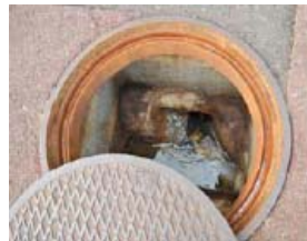
汚水桝の詰まり(例)
