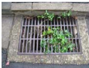
雨水桝の詰まり(例)
