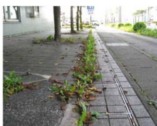
写真4 雑草の繁茂（側溝蓋）
