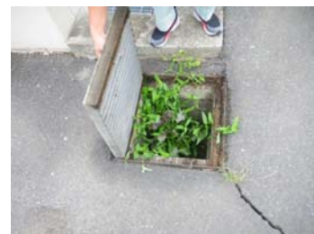
写真5 雑草の繁茂（排水ます）
