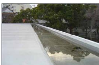
写真1 屋上に貯まった雨水
