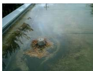
写真2 ルーフトレンの詰まり
