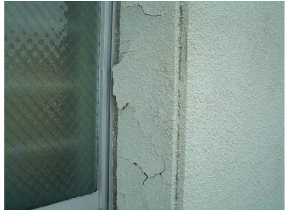
【外壁仕上げ材の浮き】
