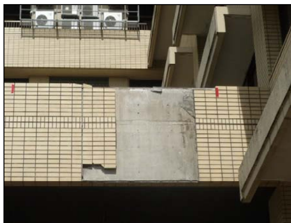
【外壁タイルの剥落】
