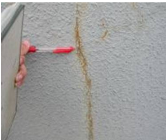
【外壁ひび割れ部の錆汁】
