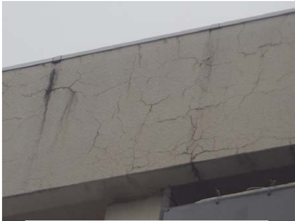
【外壁仕上げ材のひび割れ】
