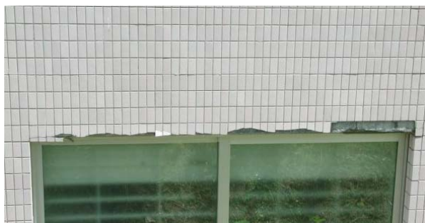
【窓上部のタイルの破損・落下】
