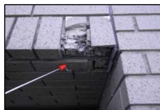
外壁被災状況
