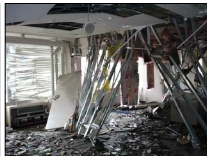
庁舎内部被災状況
