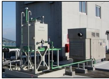
非常用発電機整備状況
