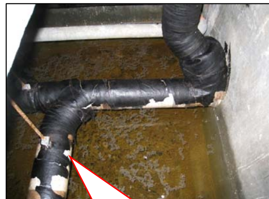
溜まった水と配管が接触している
