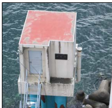
被災した釜石験潮所
