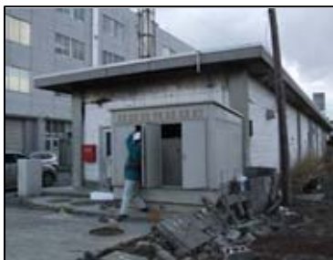
燃料槽被災状況
