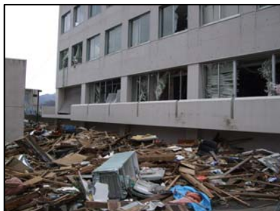
外部被災状況
