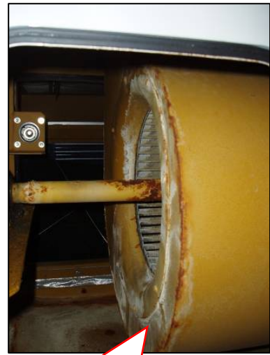
鋼材の腐食が進行している
