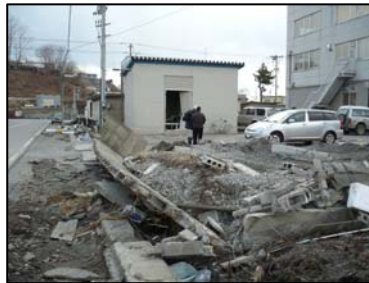
津波で被災したブロック塀
