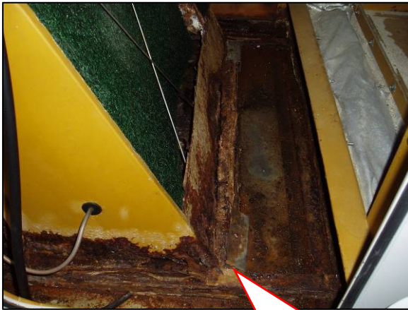
鋼材の腐食が進行している
