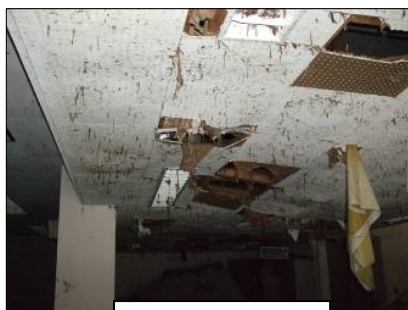
内部被災状況
