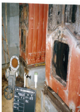
・撤去作業中のボイラー（内部の赤い色の鋳物本体が劣化してます）
