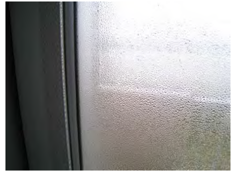
【窓ガラスとサッシ枠の結露】
