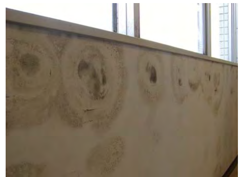
【結露によるカビの発生】
