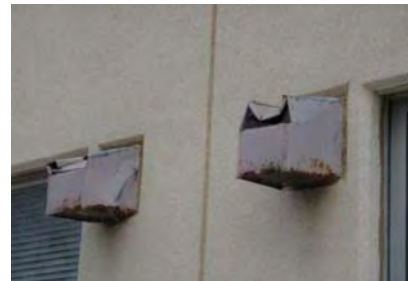
【フードの破損】
