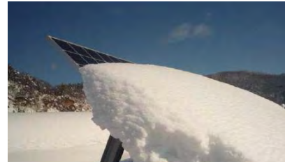
【太陽光パネルへの積雪】
