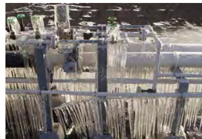
【配管の凍結破損】
