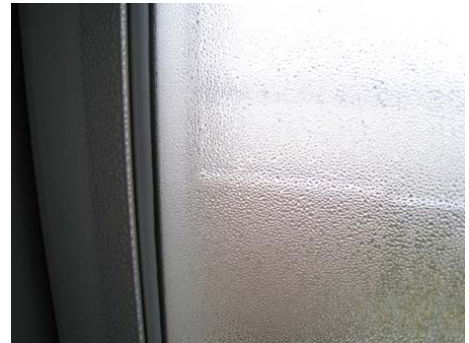
【窓ガラスとサッシ枠の結露】
