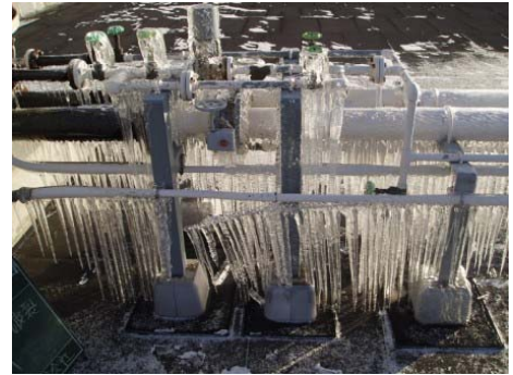
【冷却塔配管の凍結による破損】
