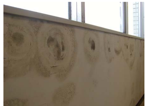
【結露によるカビの発生】
