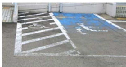
【路面塗装表示の損耗】
