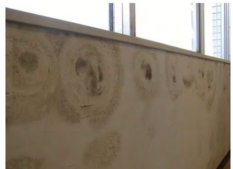
【結露によるカビの発生】
