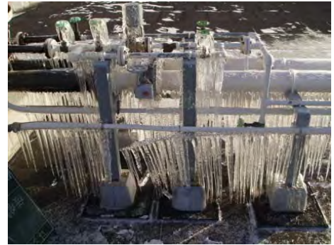
【冷却塔配管の凍結による破損】
