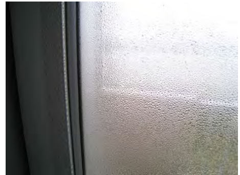
【窓ガラスとサッシ枠の結露】
