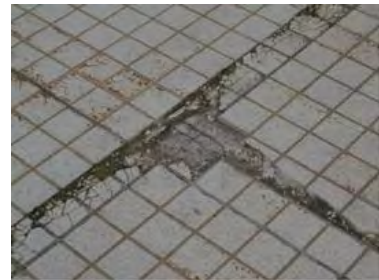
【凍害による床の段差】
