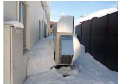
【屋外機の埋没】
